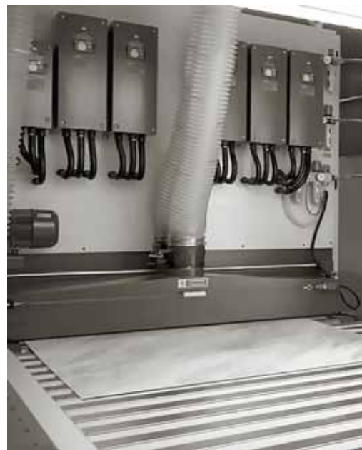
Anlagenauslauf mit „Hot Coating“-Platte in Hochglanz
